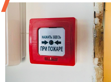
Кнопка пожарной сигнализации для самостоятельного включения
