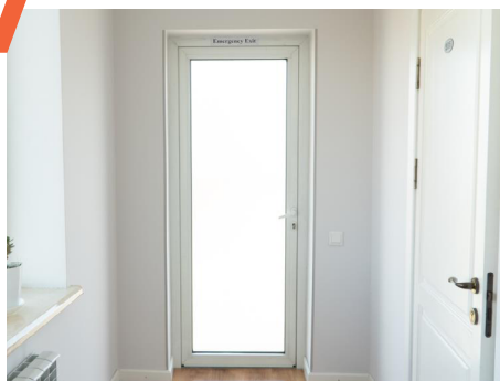
Доступ к двери эвакуационного выхода должен быть свободен
